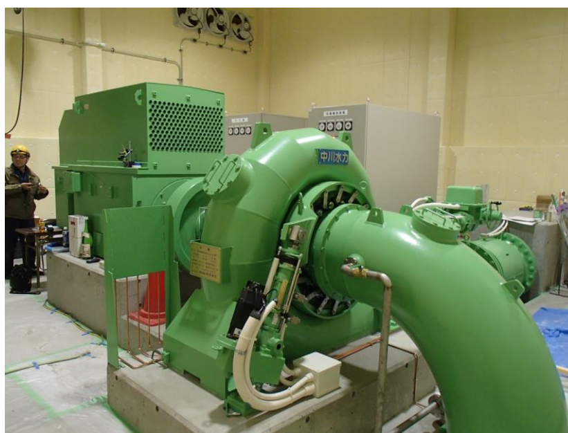
500kWの小水力発電導入事例
