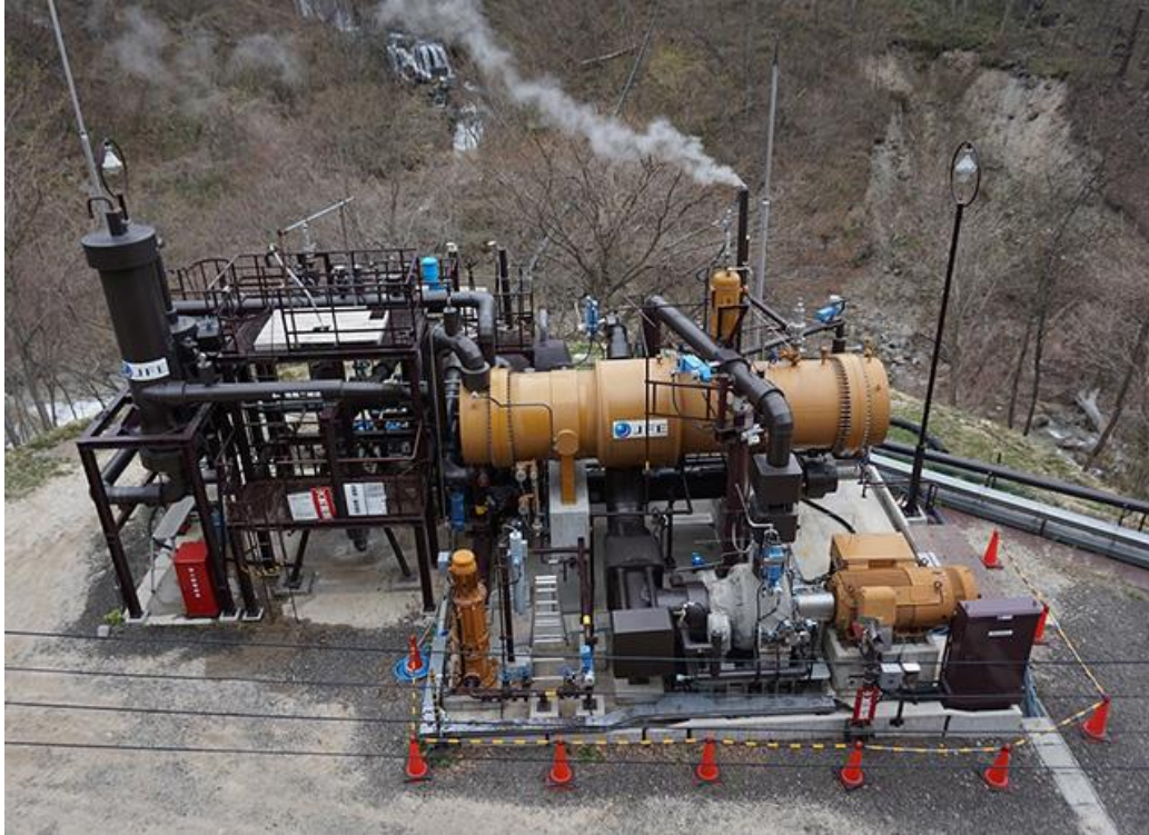
図 6-2-23 土湯温泉 16 号源泉バイナリー発電所 出典：自然エネルギー財団地熱発電が被災した温泉地に活力もたらす
